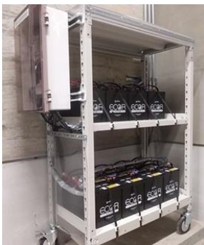
鉛蓄電池（密閉型） (8.2kWh)
